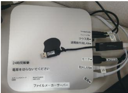
写真 1 サーバー機の配線状況について細かくシールを貼り、状況を直感的にわかるようにした例
